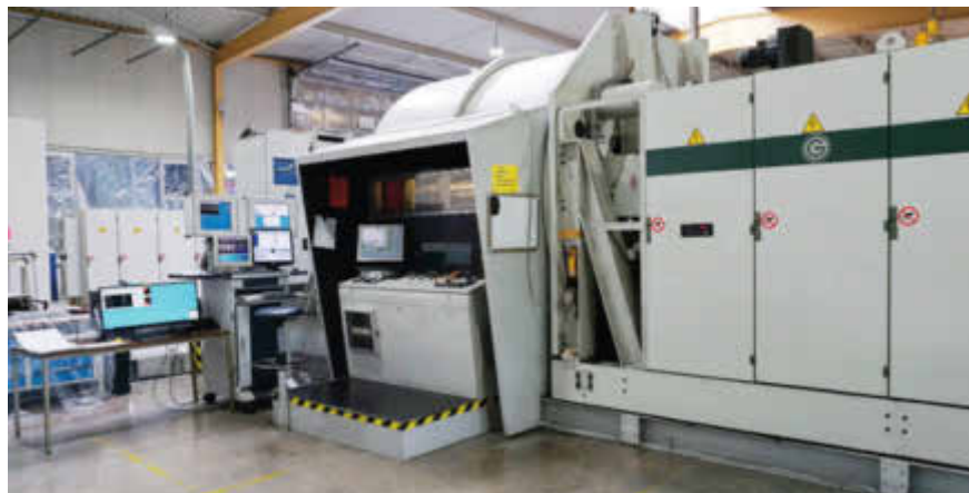
Das Bild zeigt eine Beschichtungsanlage, die mit unterschiedlichen Materialien, beispielsweise Aluminium arbeitet.
